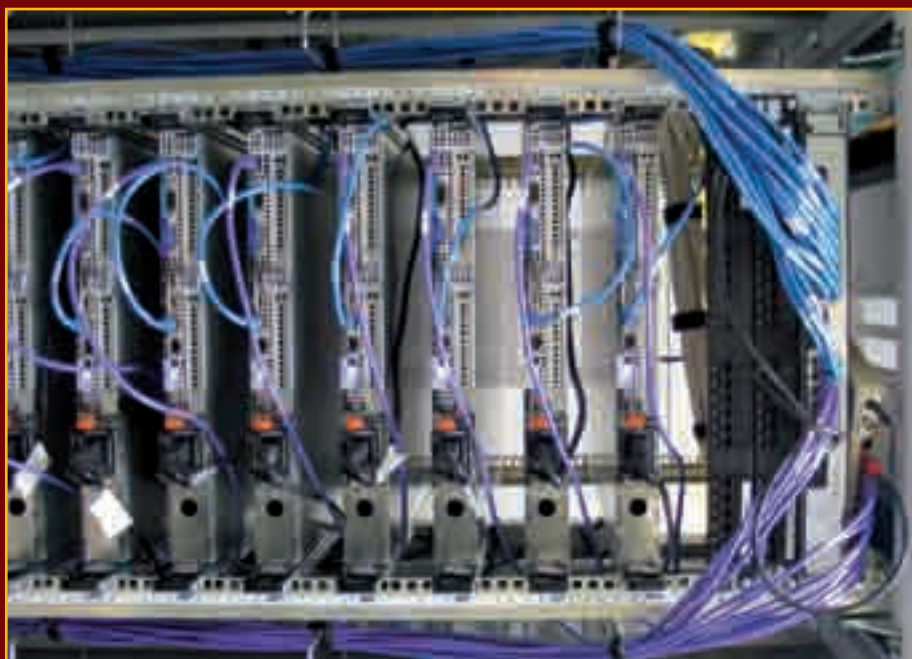
▲ I cablaggi del Rack Server di Wikipedia, ubicato ad Amsterdam.
